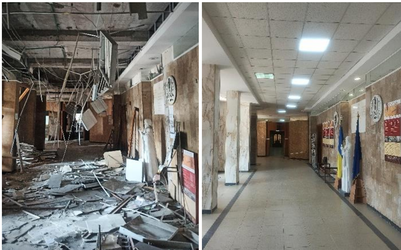
Рис. 2.2.5. Зруйнований (серпень 2022 р.) та відновлений (серпень 2023 р.) вестибюль головного корпусу
