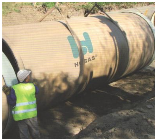
Рис. 2. Склопластикові труби для каналізації
