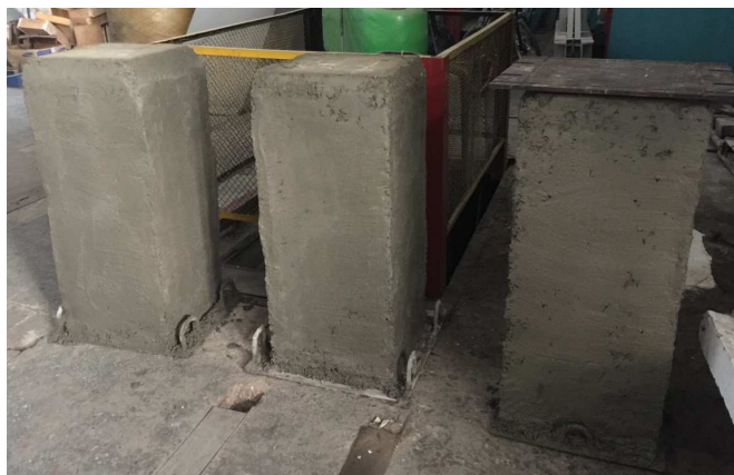
Рис. 5. Заторкретированные кирпичные столбы Ст-4, Ст-6, Ст-7
